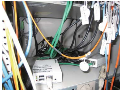
稼働中の2台のOpenBlockS 600
