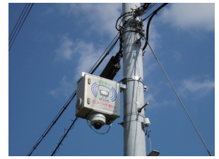
伊丹市の電柱 (OpenBlocks IoT EX1が内部に組み込まれている)
