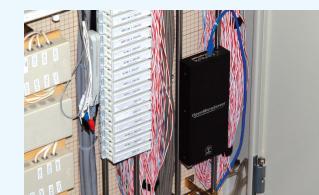
ビルのMDFへの設置
