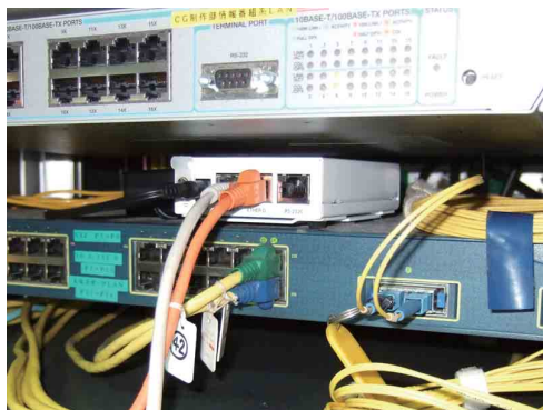
堅牢な小型の筐体を生かし、 サーバーの上のデッドスペースに設置される OpenBlockS 600
