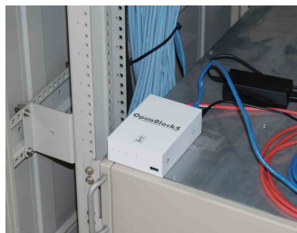
OpenBlockSによるサブネット単位の監視管理システム
